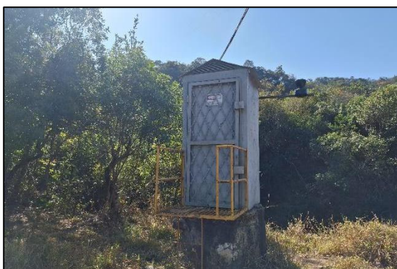
Estação fluviométrica/pluviométrica PCH Rio de Pedras - Montante. Autoria: Luísa Mosqueira Data: 14/08/2024
