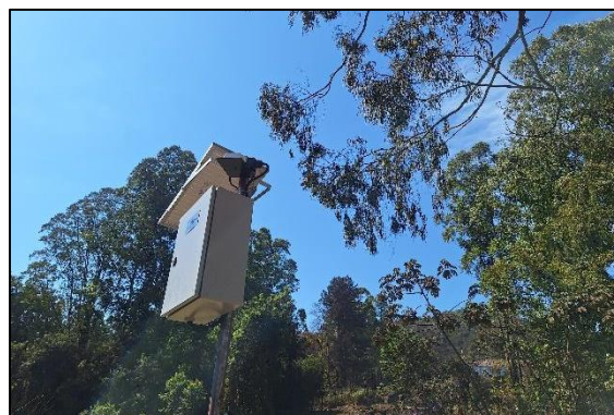
Vista do painel solar da estação fluviométrica – PCH Rio das Pedras – Rio Itabirito.
